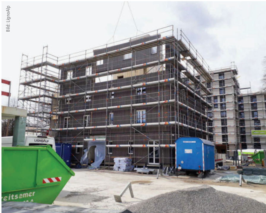
Die 500 von den Südtiroler Zimmerern von Lignoalp vorproduzierten Holzrahmenbau-Außenwandelemente mit einer Fläche von rund 4.500 m 2 wurden just in time auf die Baustelle geliefert und sofort montiert.
