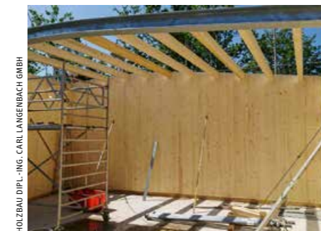
▲ Aufgrund der Geometrie des Daches und der Notwendigkeit, einen großen Bereich zu überspannen, wurden gebogene Stahlträger (I-Profil) als Hauptträger des Daches verwendet, um die Sauna stützenfrei zu halten
